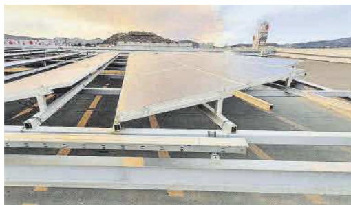
Instalación fotovoltaica en el VidaNova Parc.
